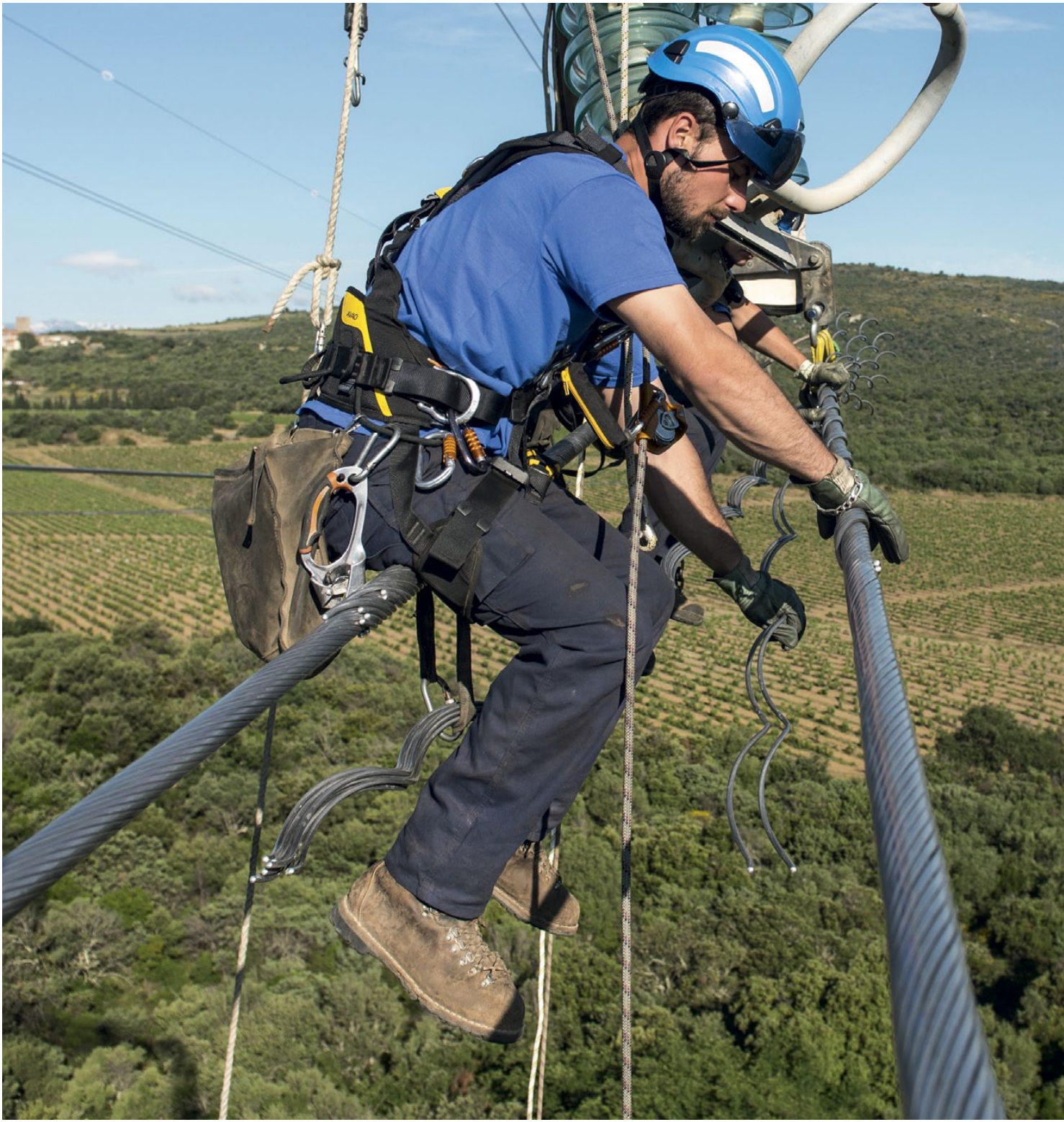
EEE - OMEXOM, ligne à 2 x 400 kV Baixas - Gaudière, La Tour de France, Pyrénées Orientales, France © Sam Blé / Lafouche
